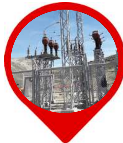
INTERCONEXIÓN DE LA LINEA DE TRANSMISIÓN 22.9 KV. CHILOTA -CHINCUNE A LA SUBESTACIÓN CHILOTA 220- 22.9 KV S/. 1'851,703.12
