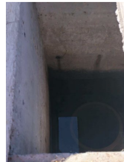
Agua estancada debido a galerías obstruidas por raíces
