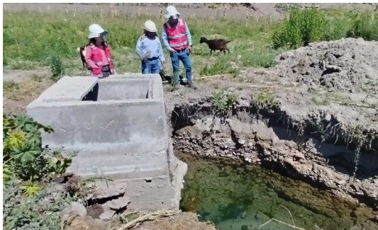
Buzon de inspección y nivel de napa freática alta
