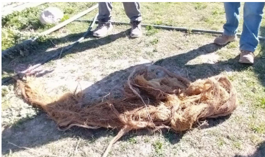
Raíces que obstruyen las tuberías de drenaje
